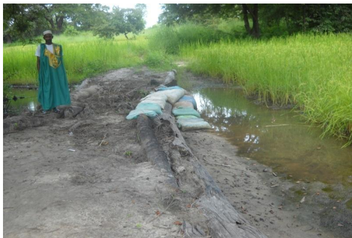
photo 09 : matériaux de construction d'une digue érodée par les fortes pluies de cette année (Imblang Diédhiou 2012).
