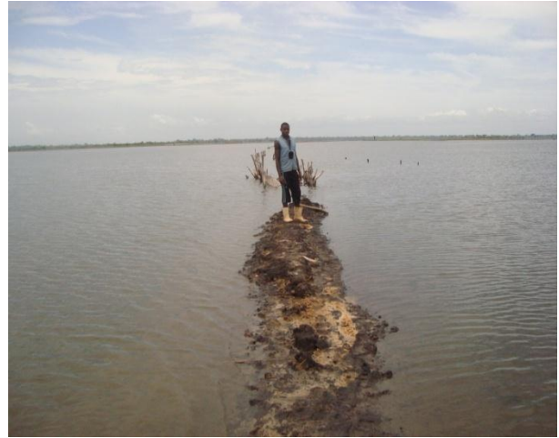
photo 11 : digue anti-sel de Marakissa cassée au niveau du lit mineur à cause des fortes (Imblang Diédhiou 2012).
